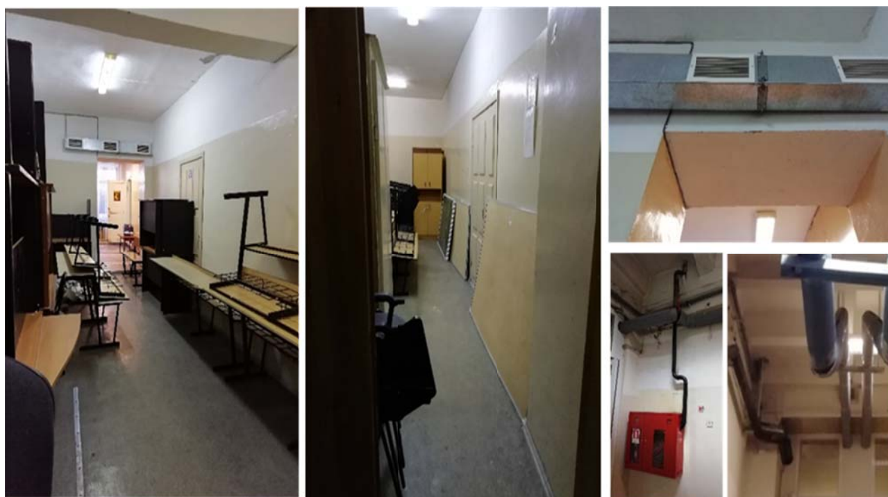
Рис. 2. «Коворкинг 2» (фотофиксация проблемных участков)
